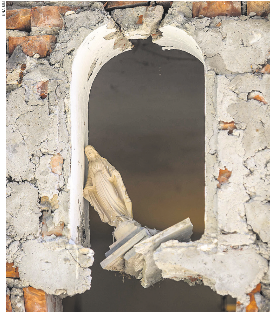
Welt in Schiefelage: Diese Marienfigur lehnt schräg in einem stark beschädigten Friedhof des von einem Erdbeben zerstörten italienischen Ortes Amatrice. Zur Trauer kommt Wut über das Versagen des Staates, für erdbebensichere Gebäude zu sorgen.
