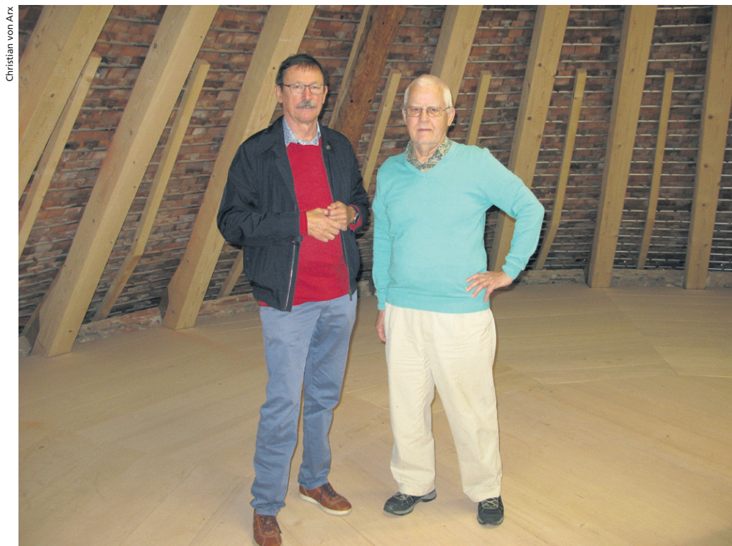
Gustav Ragettli (links) und Georg Sigrist (hier im Dachraum über der Apsis) leiteten die Sanierung.
