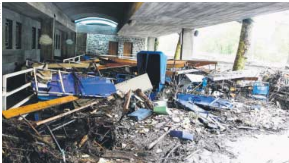
Die Zerstörung bei den Bädern zeigt das Ausmass der Schäden.
